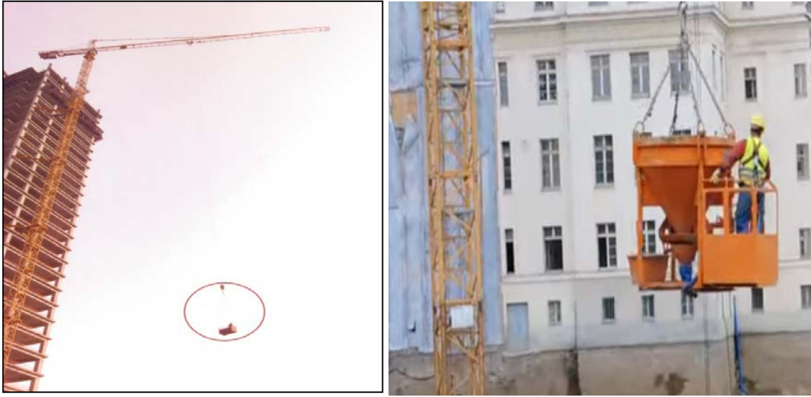
Şekil 65. Kule vinç sepetinde ve beton kovalarında insan taşınması
