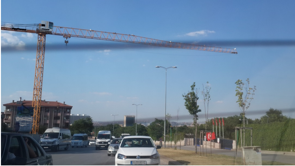
Şekil 67. Kule vincin çalışma alanının karayoluna çok yakın olması
