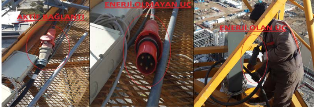
Şekil 81. Elektrik kaynaklı tehlikeler
