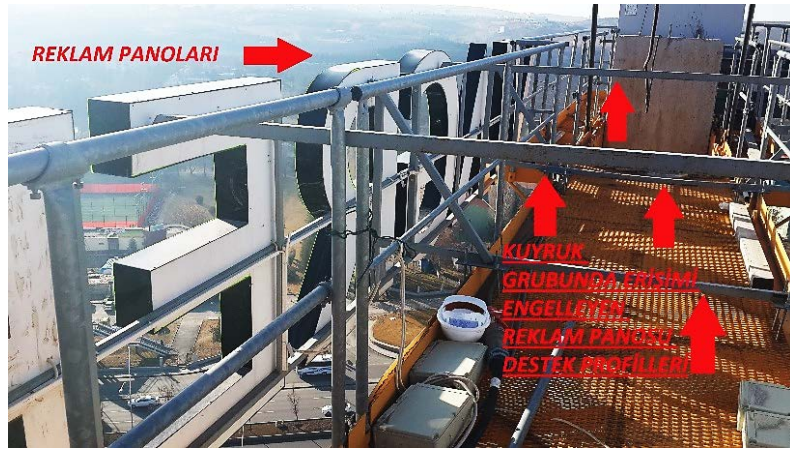
Şekil 42. Uygunsuz şekilde yerleştirilmiş reklam panosu ve bağlantıları
