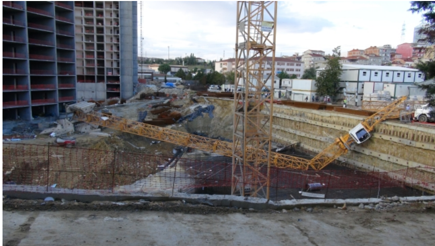
Şekil 10. Devrilen kule vincin geniş açıdan görünümü
