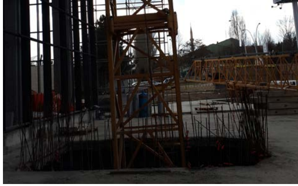
Şekil 78. Kule vinç boşluğu ve açıkta bırakılan demirler
