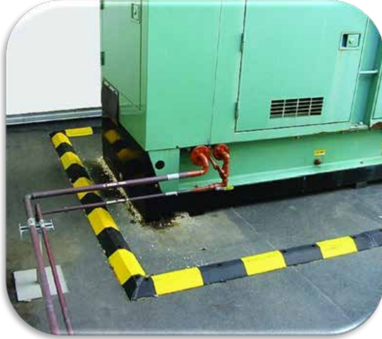
Şekil 3.7. Küçük Set Duvar (Sütne) ile Çevrelenmiş Sıvı Tankı Örneği
