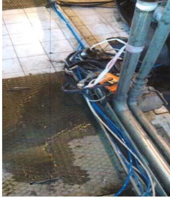
Resim 4. 4. İnce ızgara bölümünde elektrik kaynaklı tehlikeler
