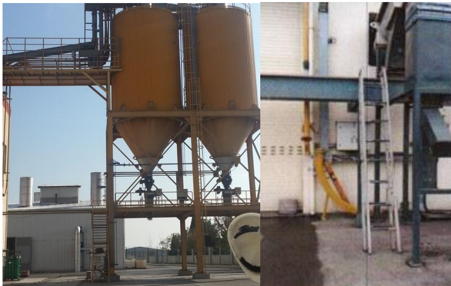
Resim 4. 10. Merdivenden düşme ve yüksekten düşme riskinin bulunduğu alanlar
