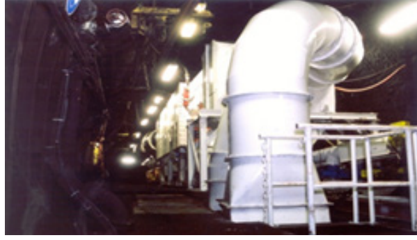
Fotoğraf 8 : Emme boruları ile tozsuzlaştırma kompakt filtre tesisi
