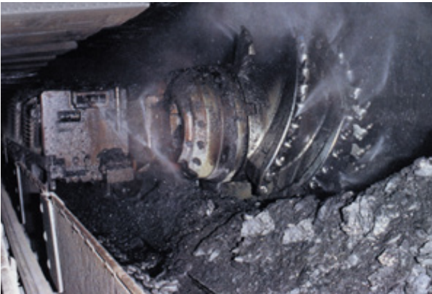
Fotoğraf 4: Mekanize kazı toz bastırma sistemi
