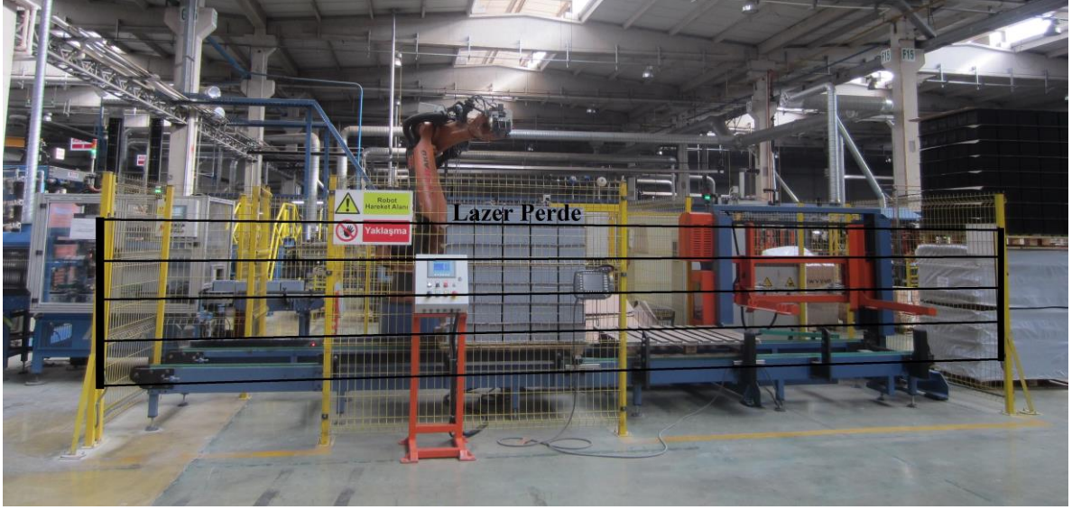
Şekil 81. Mevcut elektronik koruyucu ekipmanlar
