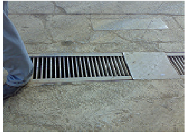
Tersane açık alanında yapılmış kablo kanalı
