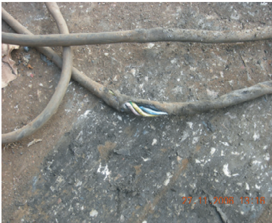
Zedelenmiş seyyar kablo
