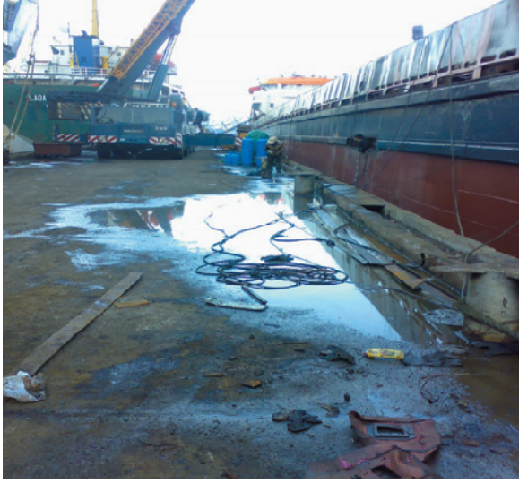
Zedelenmiş ve ıslak yer ile temas halinde korumasız elektrik kabloları
