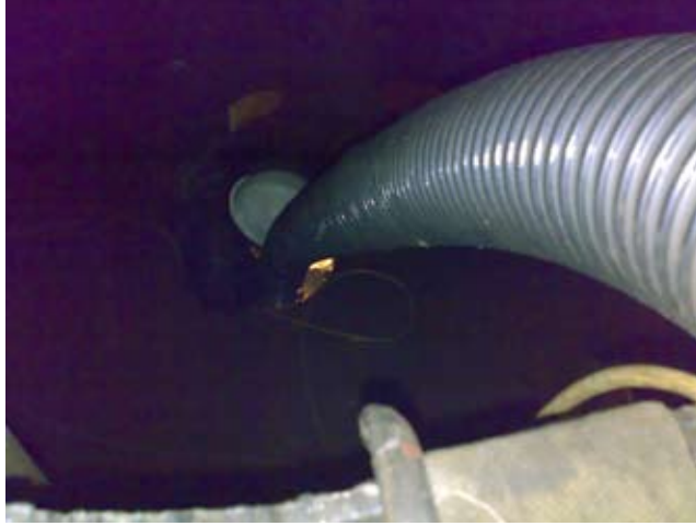
Kapalı alanda havalandırma kanalı
