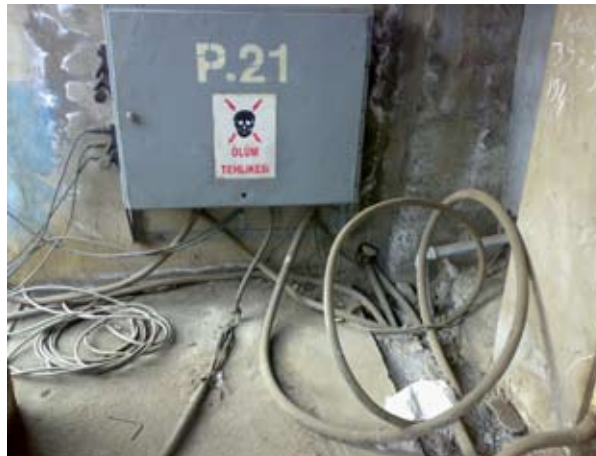
Elektrik panoları ve kablolarının uygun olmayan bağlantısı
