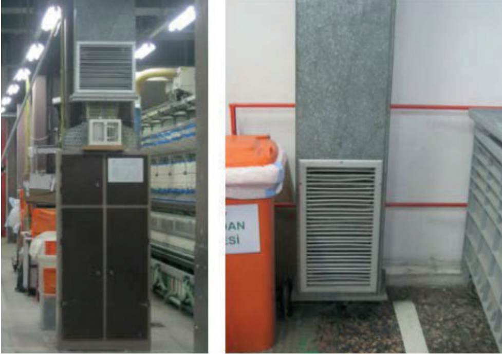
Resim 17. Kolonlarda yer alan temiz hava kanalları.
