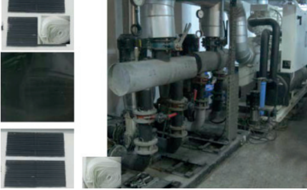
Resim 14. Düzenli bakım yapılan verimli çalışan klima tesisleri.
