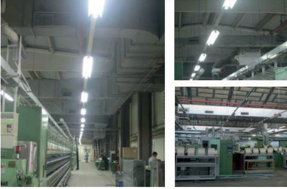
Resim 16. Tavandaki temiz hava kanalları.
