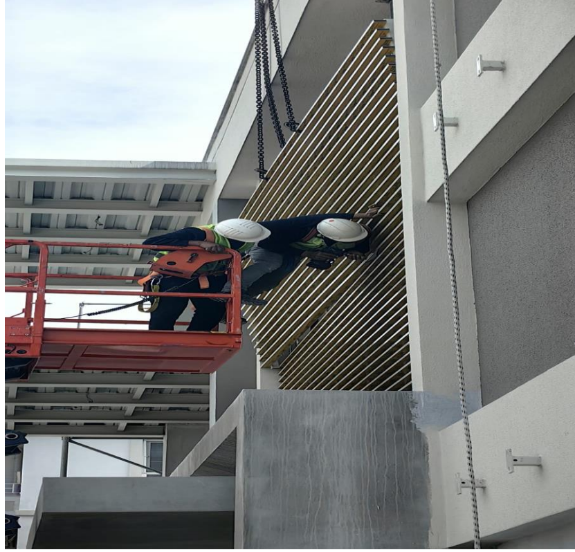
Resim 3.6. Korkuluğa basarak uygunsuz davranışta bulunan operatör
