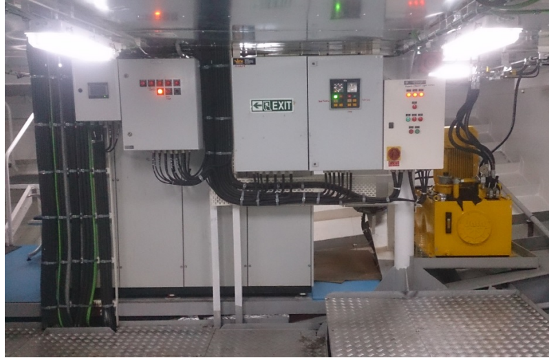
Şekil 2.6. Düzgün Yalıtılmış, Sabitlenmiş ve Düzenli Elektrik Panosu Örneği
