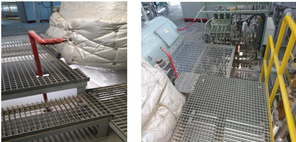
Şekil 3.2 - Eksik Korkulukların Tamamlanması
